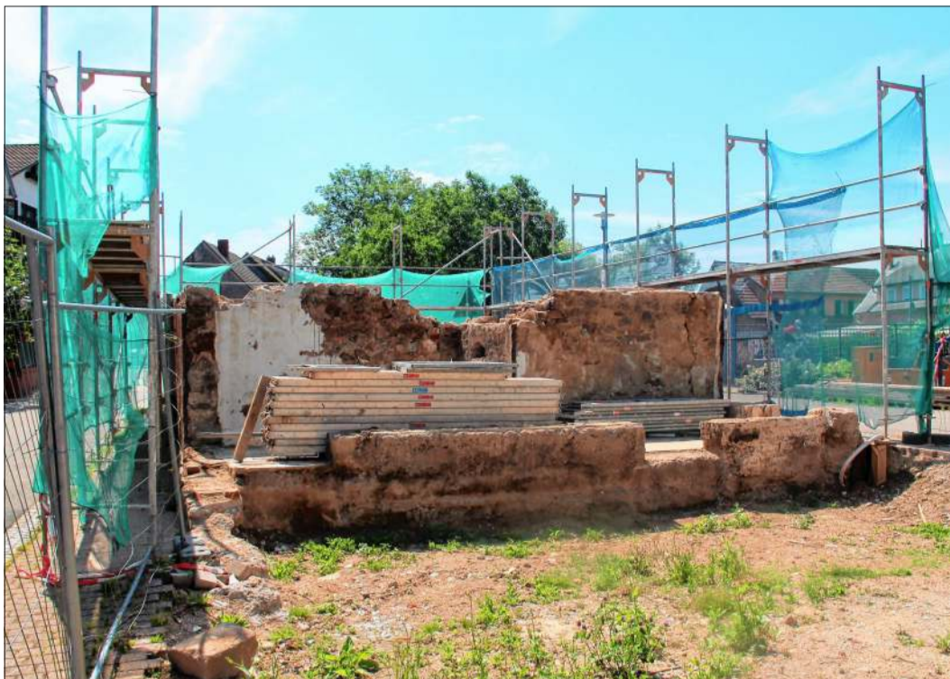
Nur noch die Grundmauern stehen. Die Pläne, die dem Renchener Gemeinderat im Juli 2017 vorgelegt wurden, sind offensichtlich hinfällig. Denn laut Stadtbauamt wurden wegen neuer Bedingungen neue Unterlagen eingereicht. Foto: Peter Meier
